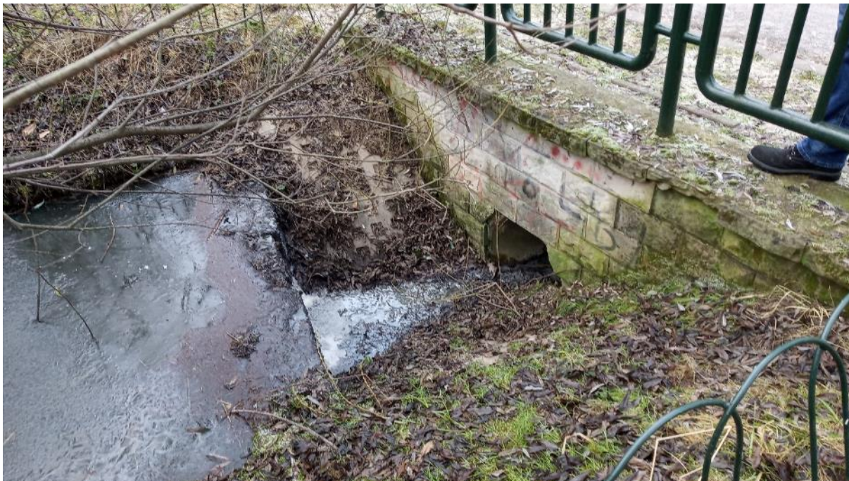
Fotografia 34. Widok na przepust P4 oraz zastawkę piętrzącą poziom wód w S5 (źródło: własne)
