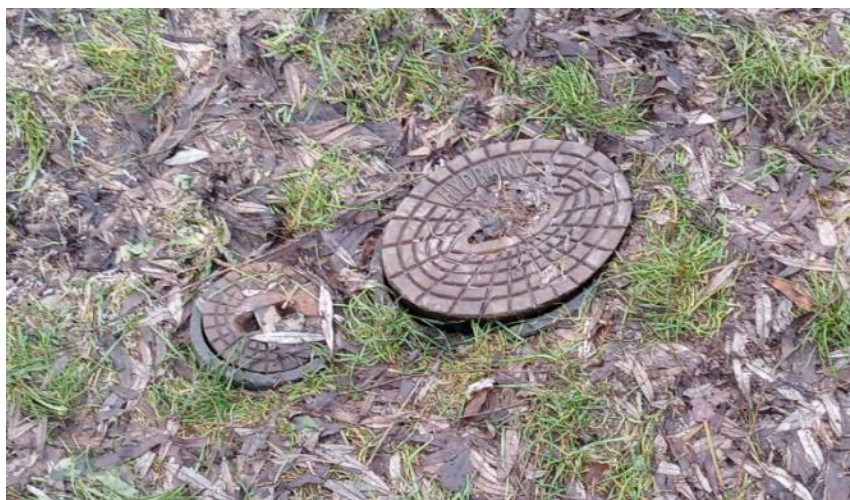
Fotografia 7. Hydrant przy obniżeniu terenu tuż przy zbiorniku S5, w którym zalega woda opadowa (źródło: własne)
