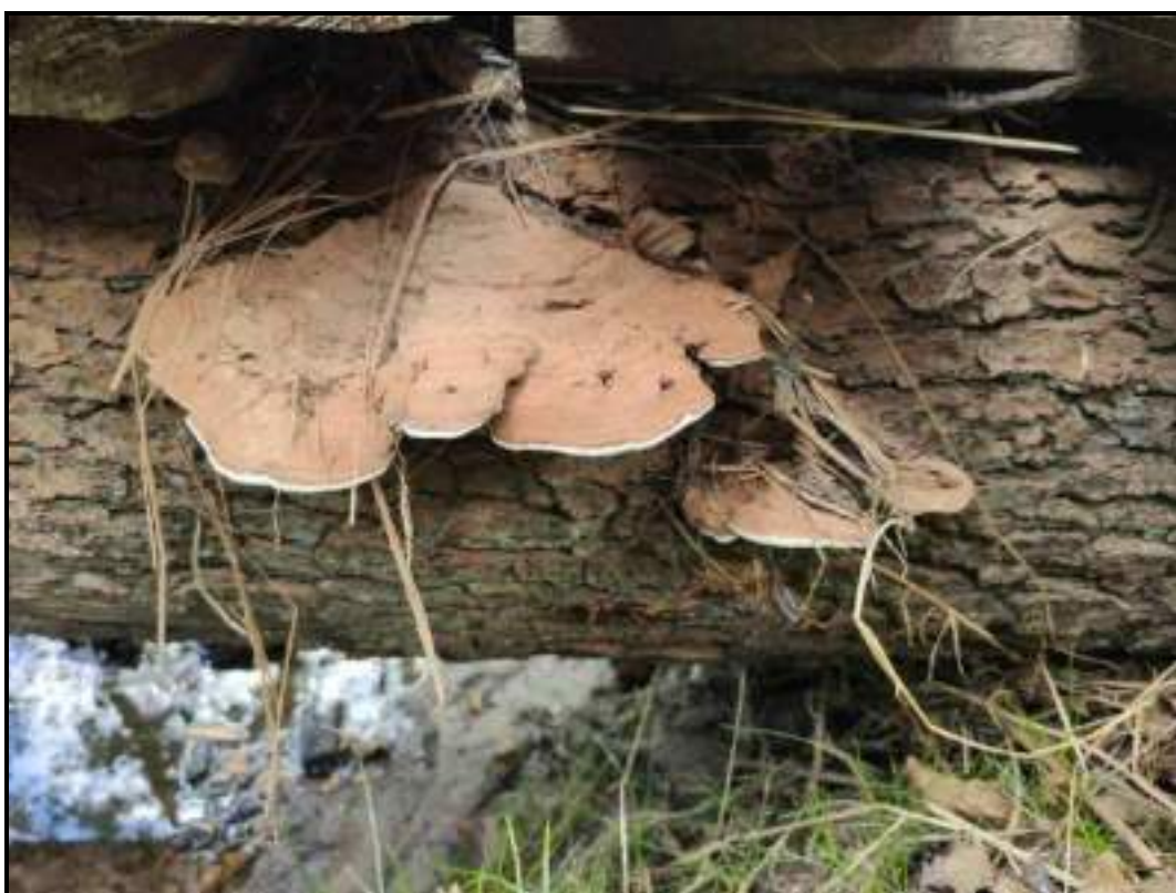
Powodująca intensywną zgniliznę typu białego lakownica spłaszczona ( Ganoderma applanatum ) na kłodzie olchowej na mostku nad Drwinką. fot. MK
